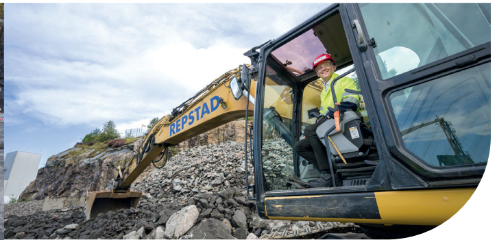
Le maire de Kristiansand, Mathias Bernander, cassant la première pelle symbolique avec une excavatrice sur le chantier d'Agder
